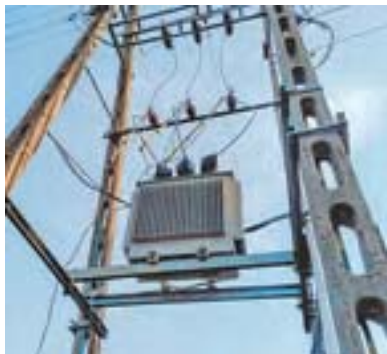
Рис. 67. Трансформатор с масляным охлаждением
