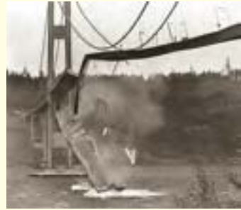
Рис. 29. Разрушенный мост через реку Такома (США)
